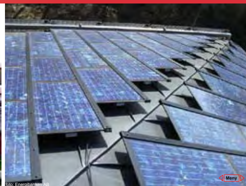
Ur Solceller i byggnader – nya möjligheter/ Energimyndigheten.
