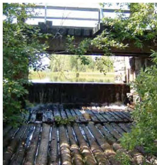
Flottningsdamm i Sikbäcken som ska åtgärdas inom projektet. Den tvära kanten utgör ett vandringshinder för fisk. Nivåskillnaden ska fördelats på en större yta vilket skapar en fors så att fisken kan ta sig upp. Foto Daniel Holmqvist
