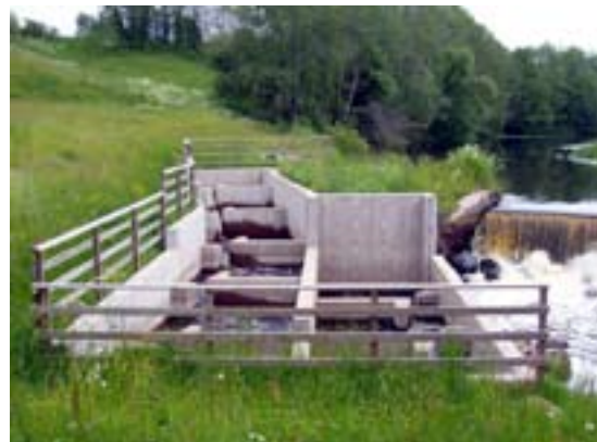
Figur 17. Vy uppströms av slitsrännan vid Flaka kvarn i Åtran. Plats 642140-136100, Karta 7 D SV. Foto: Morgan Andersson, Länsstyrelsen i Västra Götalands län.
