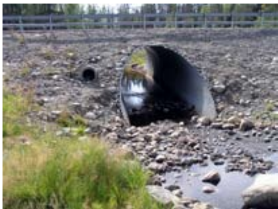
Figur 11. Nedgrävd heltrumma med högre liggande utterpassage i form av en rund betongtrumma i ett biflöde i Öreälvens övre avrinningsområde, Västerbotten.
