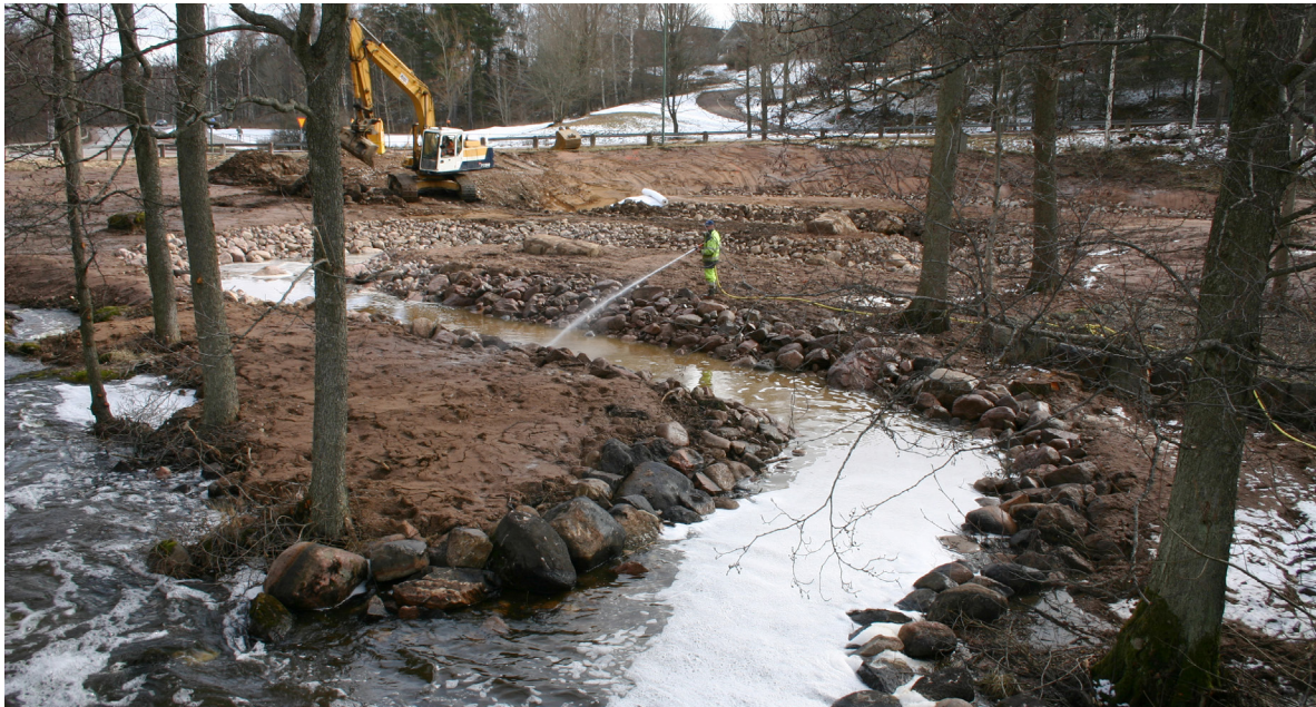
Miljöanpassningar av vattenkraftverk innebär arbetstillfällen för byggentreprenörer. Här omlöpsbygge vid Åsvallebult. Foto Lennart Gustavsson.
