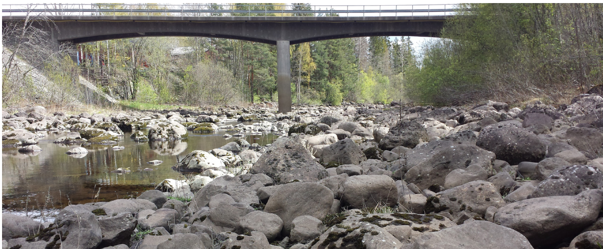
Torrläggelse av flodfåror, som här i Voxnan, Sunnerstaholm, ställer till stor skada för livet i vattnet. Men med relativt små åtgärder kan skadorna minskas. Foto: Jonas Engberg
